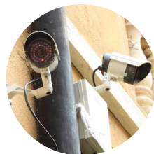
Backhaul de Videovigilancia
